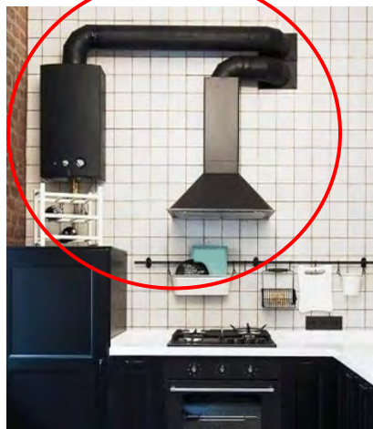
установка электромеханических вытяжек в помещении с установленным отопительным и водогрейным оборудованием с открытой камерой сгорания
